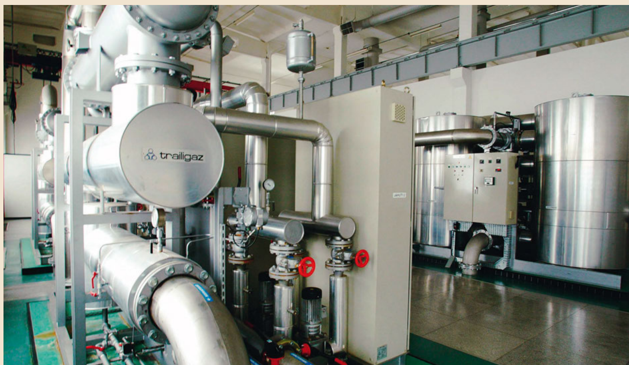
Osooni tootmiseks mõeldud õhu ettevalmistusseadmed Tallinna veepuhastusjaamas
